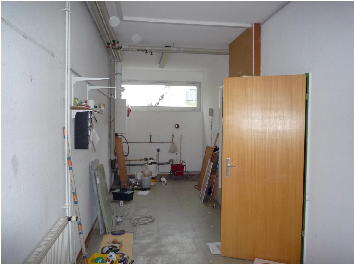
Foto 5 Ebenerdiger Raum mit den Hausanschlüssen und der Gastherme
